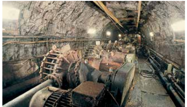
686 metre kotta yer alan bir önceki pis su çamuru seri 12 adet tek kademeli santrifüj pompa odası 141 metre yukarıdaki bir sonraki 545 metre ters kotta kumlu su nakletmektedir.
